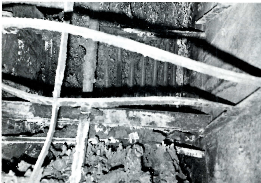
De noodzakelijke passage voor het uitdrijven van de uitlaatgassen van de hoofdmotor was geheel geblokkeerd
